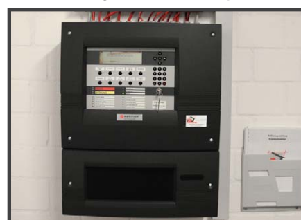
Foto: Die Brandmelderzentrale NF 3000
